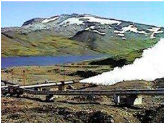
Pozo COP-4 y tramo de vaporducto. Al fondo de la imagen el volcán Copahue
